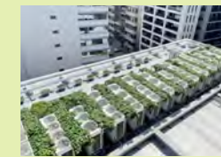
ウノサワ東急ビルの芋緑化システム
