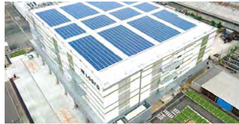
リエネLOGI'Q京都久御山太陽光発電所
